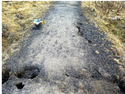
Holur eftir steina sem komu upp vegna frostlyftingar og vatns.
